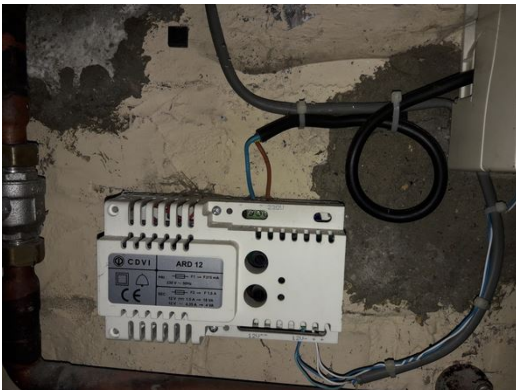
connexion présentant des parties actives nues sous tension ; conducteurs isolés non protégés mécaniquement / local technique (sous-sol)
