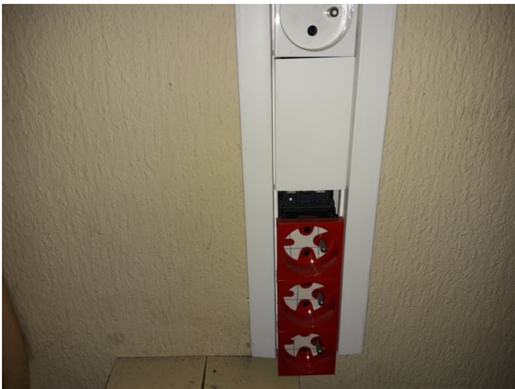
Parties actives nues sous tension : risque de contact direct / Archive 1er étage
