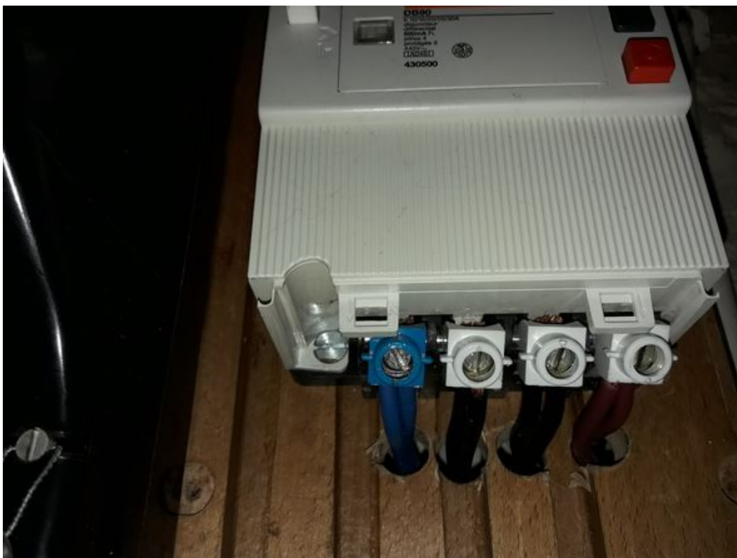
Disjoncteur de branchement / local technique
