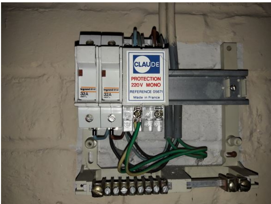
Calibre 32A de la protection contre les surintensités inadapté à la section des conducteurs / Local technique (sous-sol)
